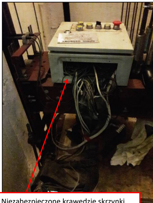
Niezabezpieczone krawędzie skrzynki
