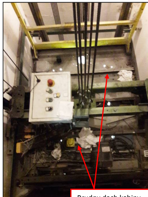
Brudny dach kabiny
