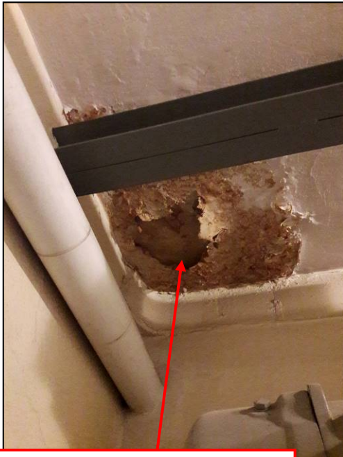
Zniszczony tynk na suficie
