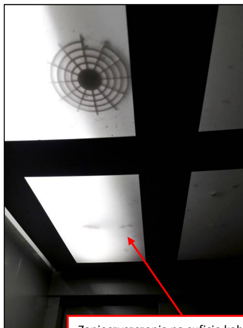
Zanieczyszczenia na suficie kabiny
