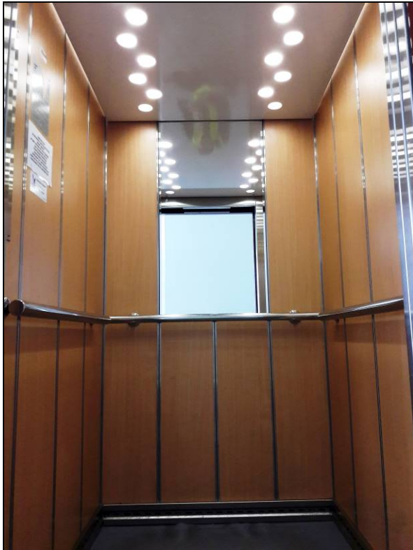
Kabina dźwigu lewego [7]
