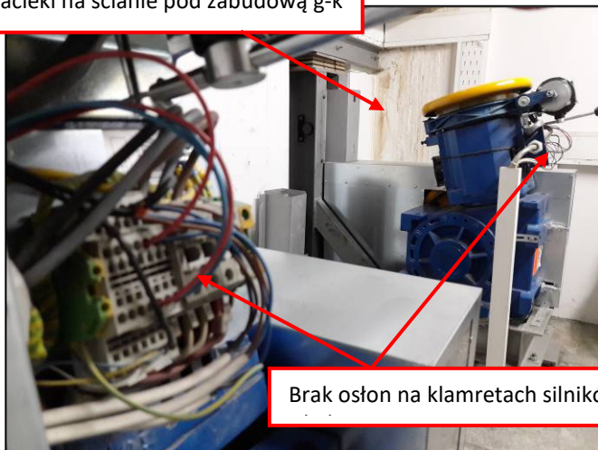
Zacieki na ścianie pod zabudową g-k
