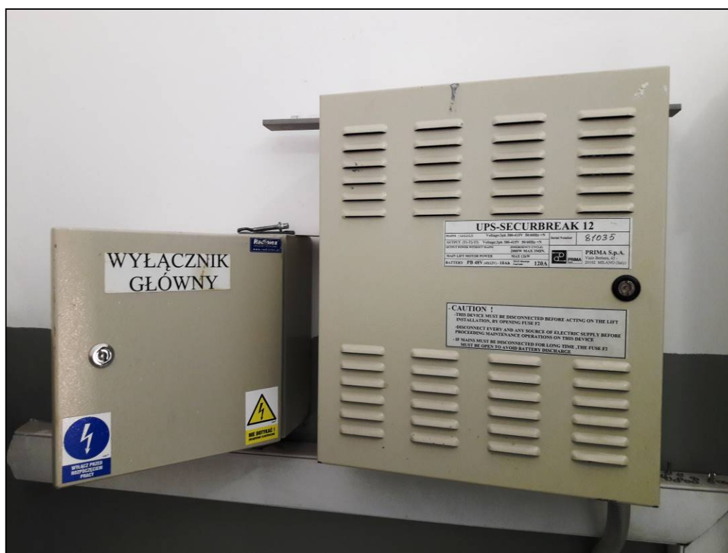
Tablica wstępna i zasilacz UPS dźwigu [6]
