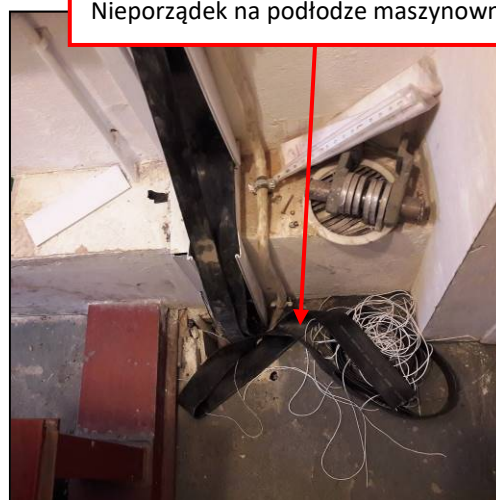
Nieporządek na podłodze maszynowni
