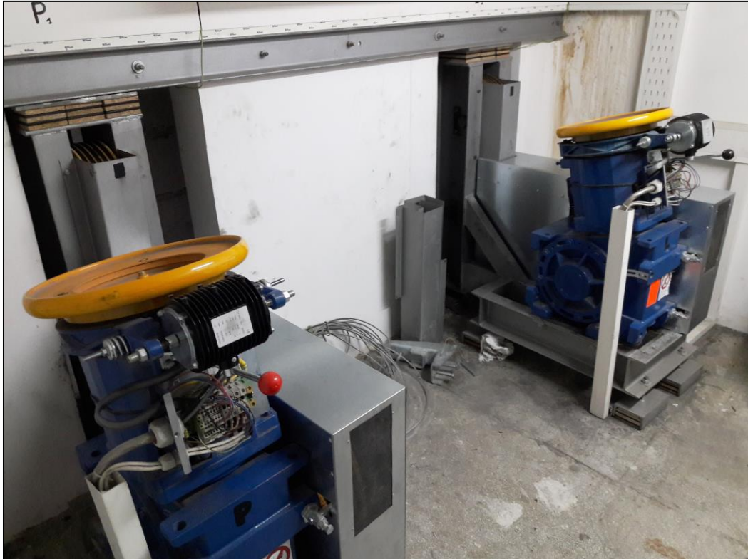
Wciągarki dźwigów lewego i prawego [7, 8]
