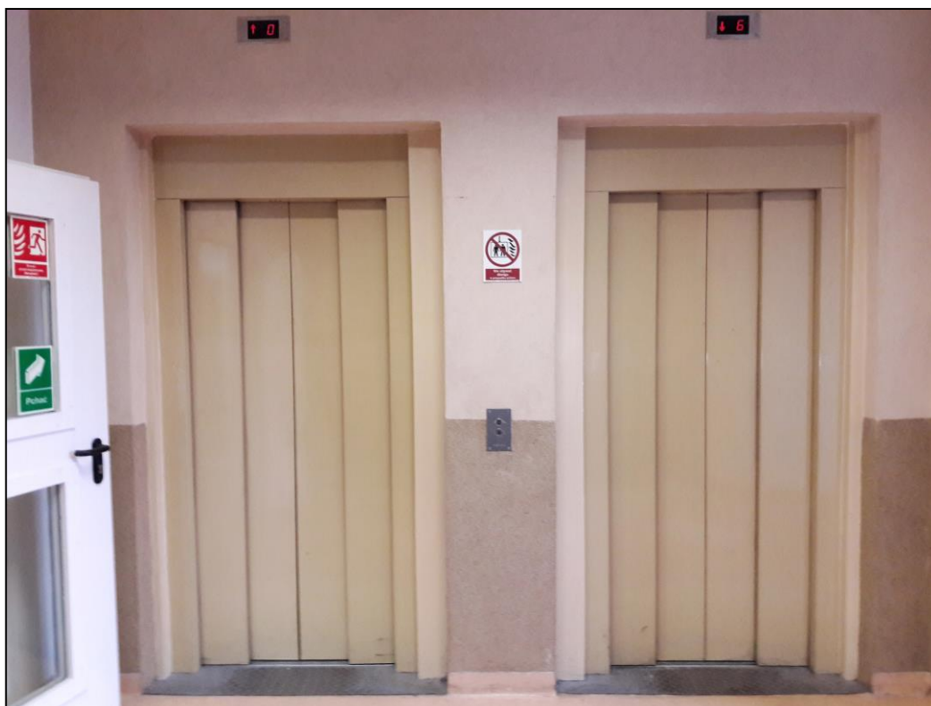
Przystanek „1” dźwigów lewego i prawego [4, 5]
