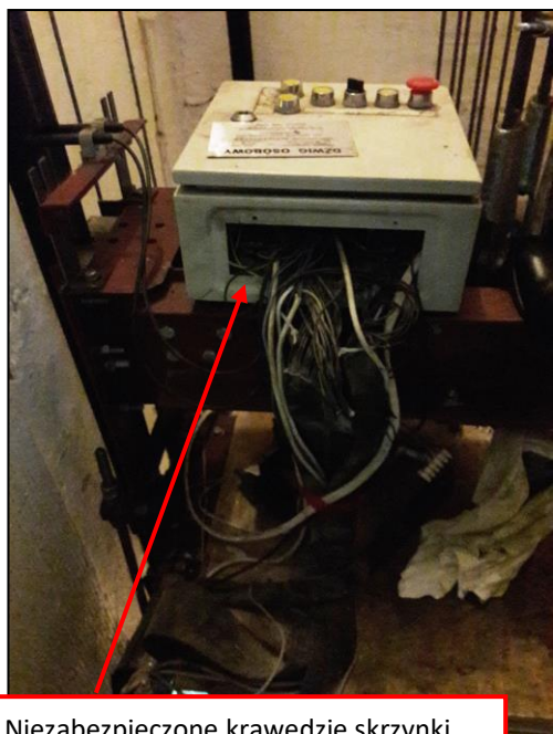
Niezabezpieczone krawędzie skrzynki
