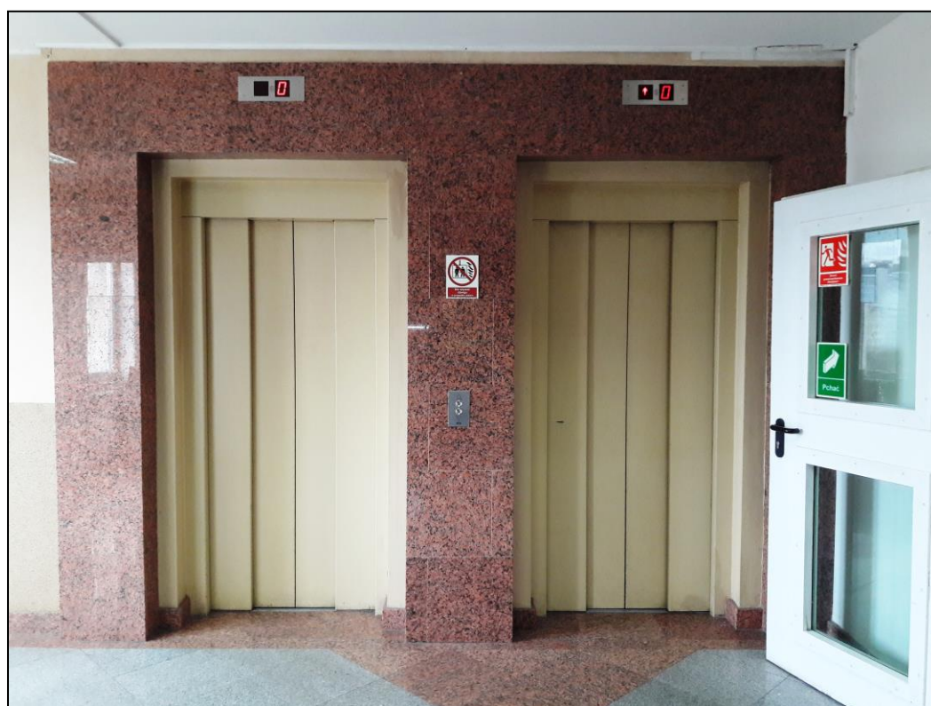
Przystanek „5” dźwigów lewego i prawego [7, 8]
