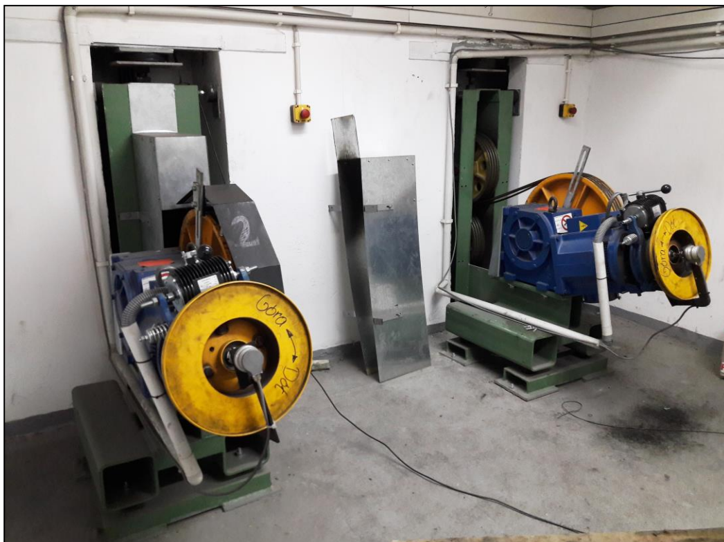
Wciągarki dźwigów lewego i prawego [1, 2]
