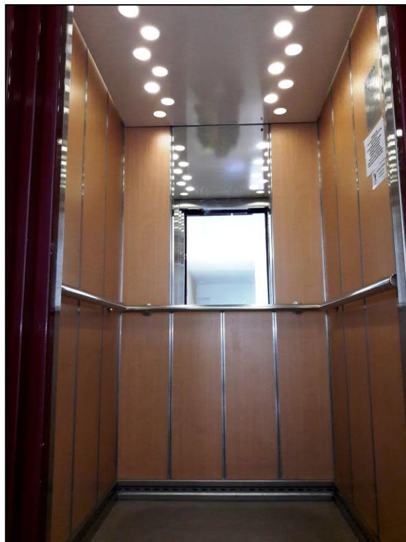
Kabina dźwigu prawego [8]
