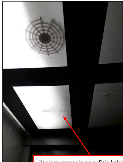
Zanieczyszczenia na suficie kabiny
