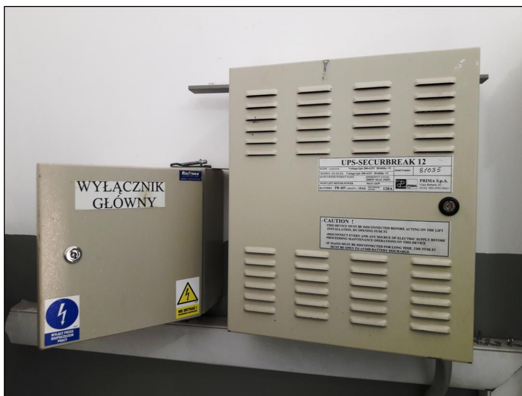
Tablica wstępna i zasilacz UPS dźwigu [6]
