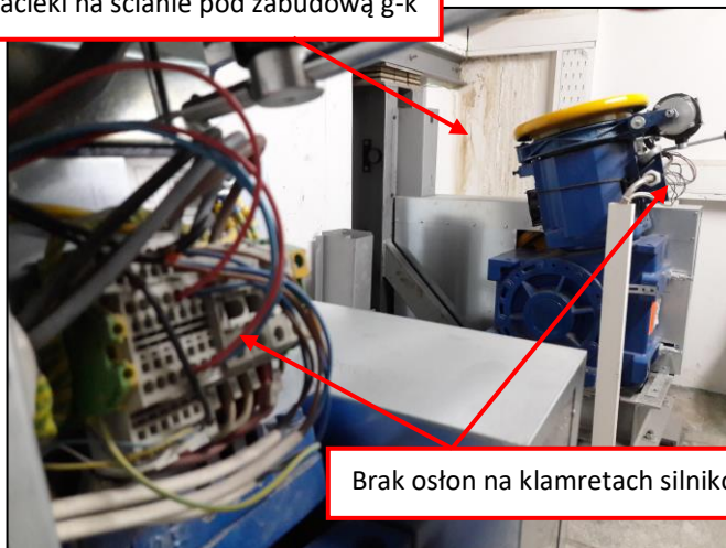
Zacieki na ścianie pod zabudową g-k
