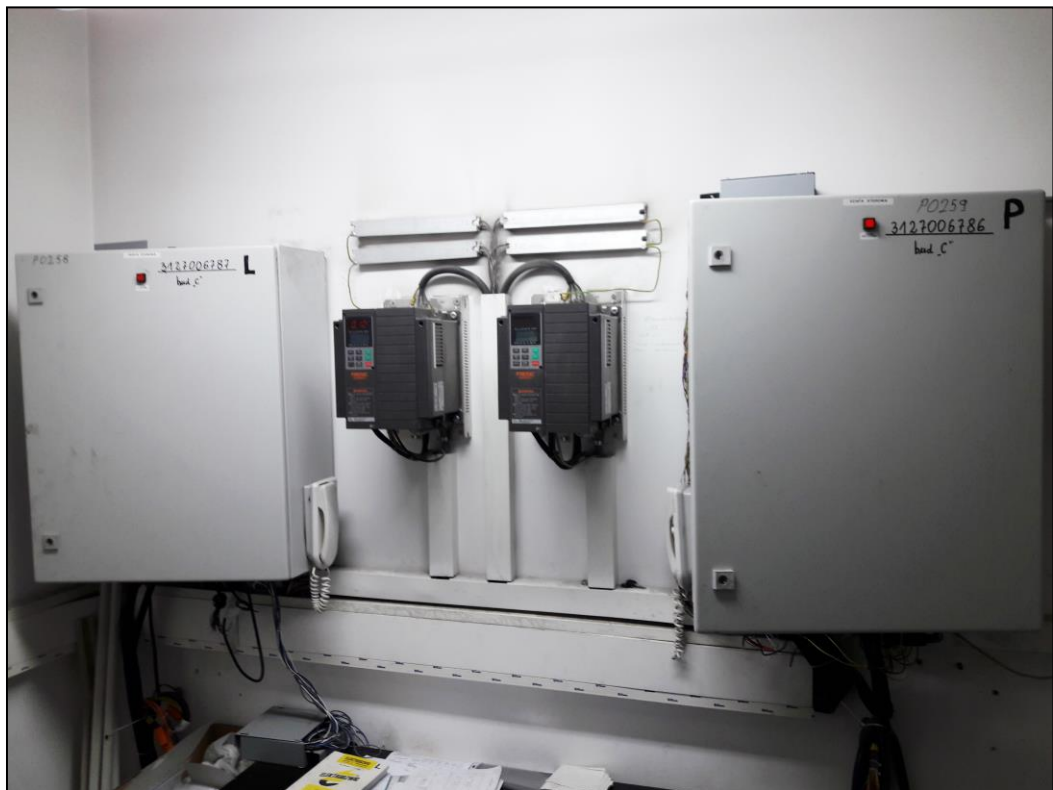
Tablice sterowe z falownikami dźwigów lewego i prawego [7, 8]
