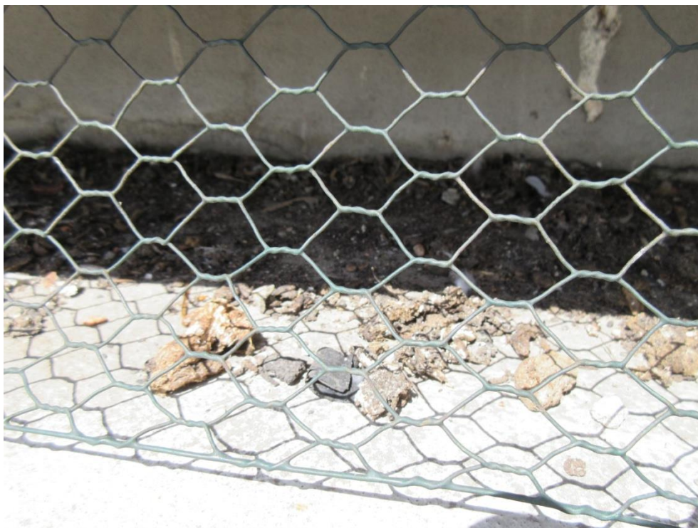
Fot. 15. Guano gołębi pod blachą zabezpieczającą balustradę i za siatką zabezpieczającą.
