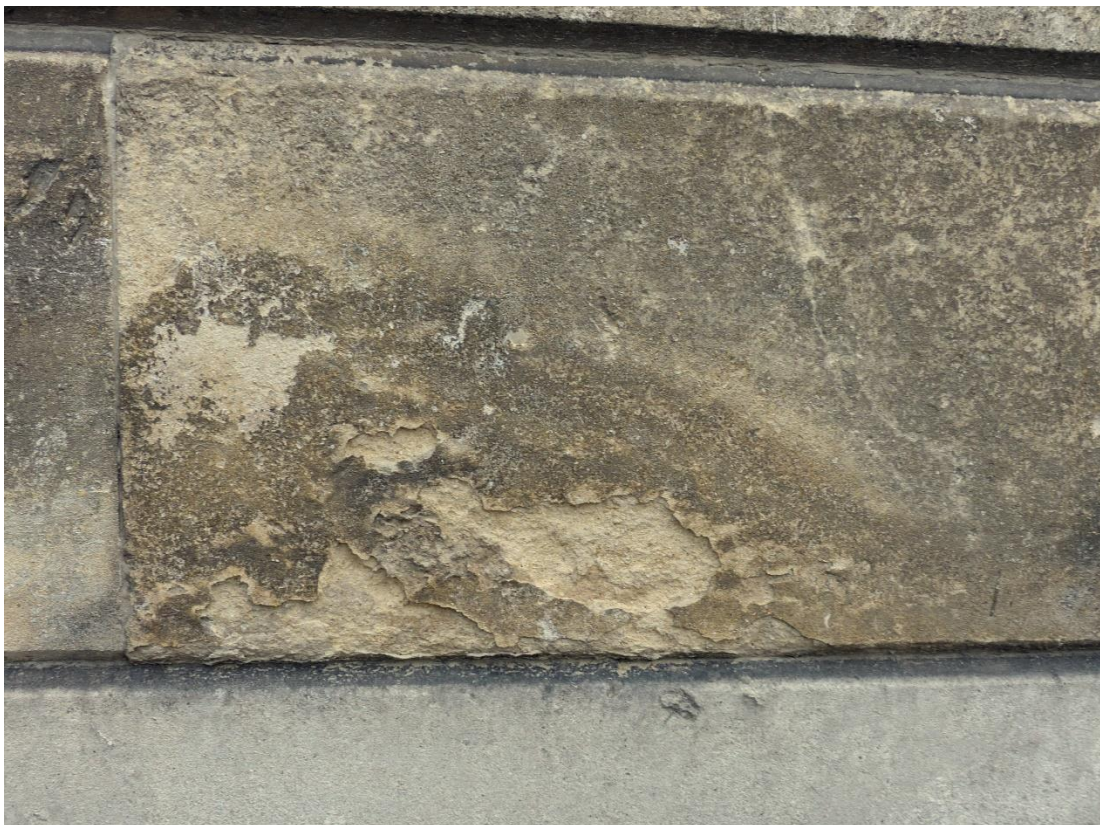
35. Fragment boniowania na elewacji północnej skrzydła „B”. Ubytki spowodowane korozją powierzchni kamienia.
