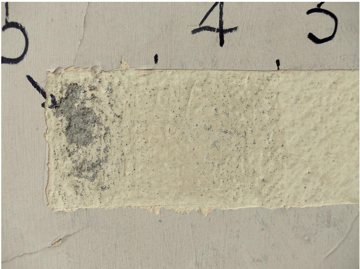
32. Fragment odkrywki nr 4, z pierwszą zachowaną warstwą malarską na powierzchni zaprawy cementowej betonu.
