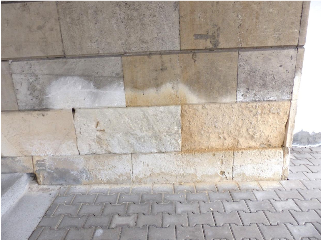
34. Płyciny okładzinowe z wapienia, który uległ korozji na skutek zasolenia i zawilgocenia. Fragment elewacji zachodniej łącznika skrzydeł w prześwicie parteru skrzydła „A”.
