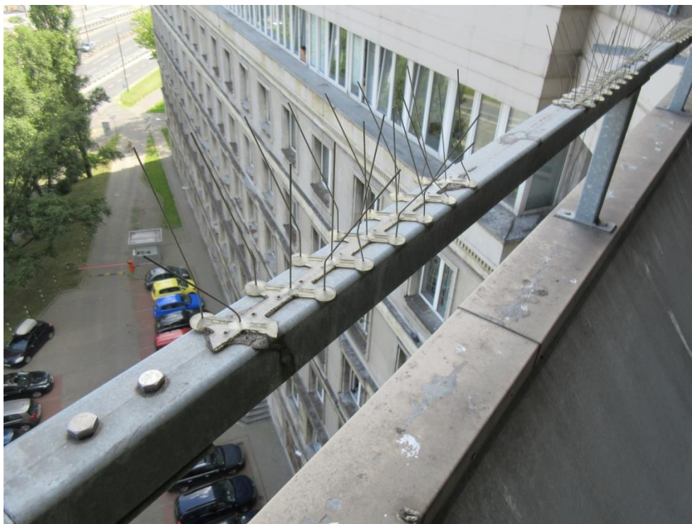
Fot. 23. Kolce zabezpieczające na balustradzie na VIII kondygnacji.
