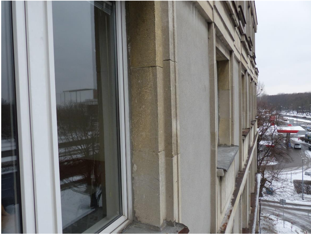
13. Fragment elewacji zachodniej skrzydła „C”, z szeregiem okien trzeciego piętra widoczny z perspektywy piątego okna, przy którym wykonano odkrywkę nr 1.
