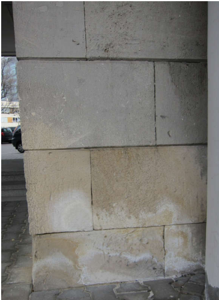
Łącznik skrzydeł budynku z typowymi wykwitami solnymi.
