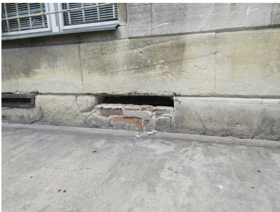
Fot. 12. Niezabezpieczony wlot wentylacyjny – skrzydło wschodnie, od strony południowej.
