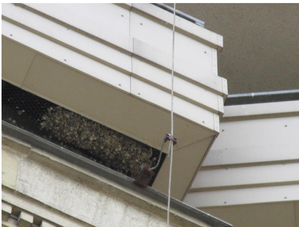
Fot. 20. Zabezpieczenie siatką półki na VII piętrze i guano gołębi.
