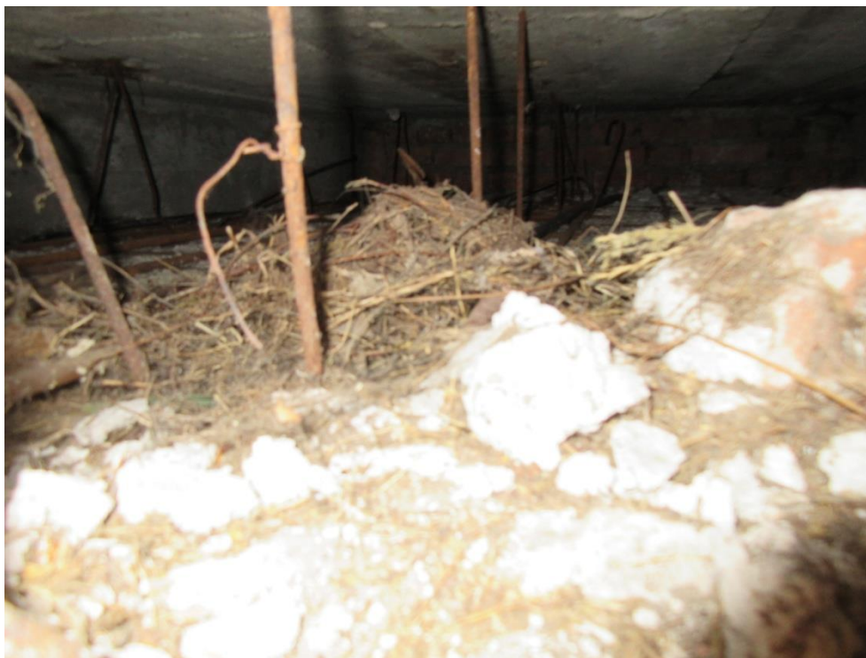
Fot. 27. Pozostałości gniazda, prawdopodobnie kopcjuszka, nad przejazdem na dziedziniec budynku garaży.
