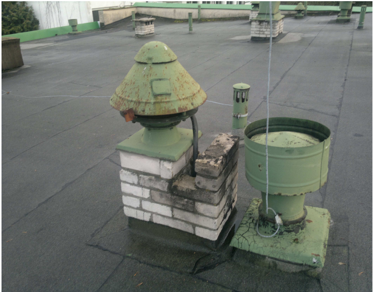
Wyloty przewodów wentylacji kotłowni zakończone wywiewnikami dachowymi.
