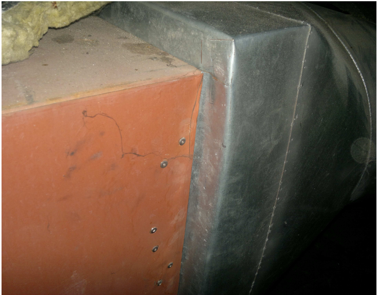
Połączenie kanału ciągu odpływu spalin – miejsce połączenia kanału z blachy stalowej z kanałem ze stali kwasoodpornej.
