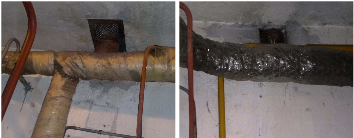
Wloty wentylacji dwóch pomieszczeń kotłowni.
