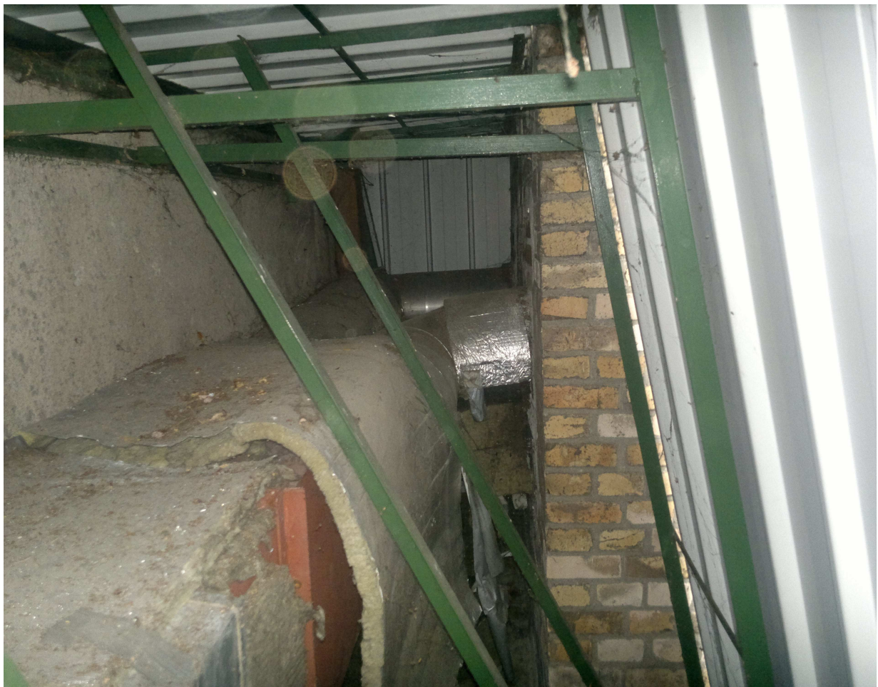
Poziomy kanał odprowadzający spaliny z pieców umiejscowiony pod zadaszeniem między zewnętrzną ścianą budynku a kominem wolnostojącym. Widoczne nieosłonięte części wlotowe kanału do kмина.
