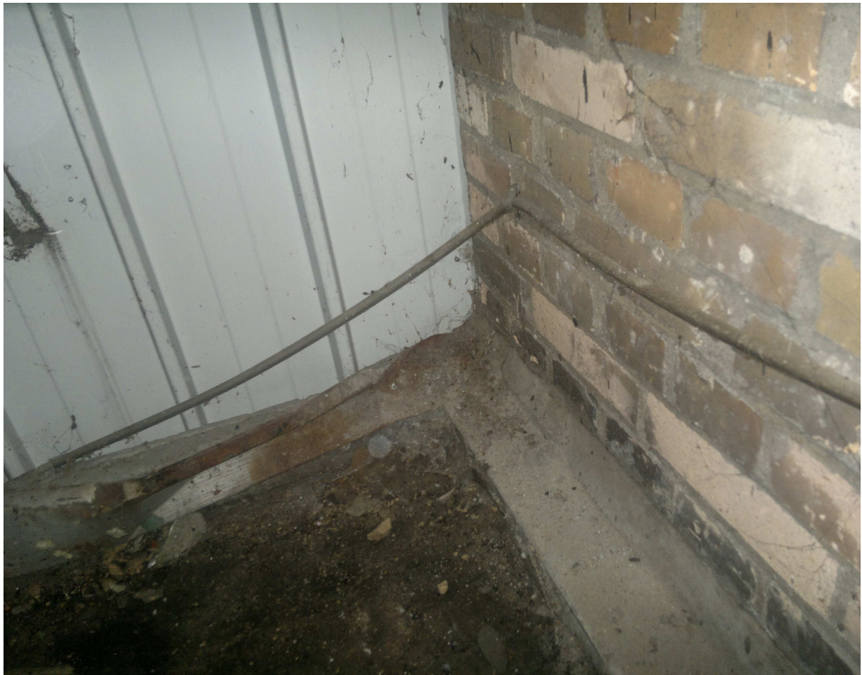
Luźno zwisający przewód z częściowo poziomym odpływem.
