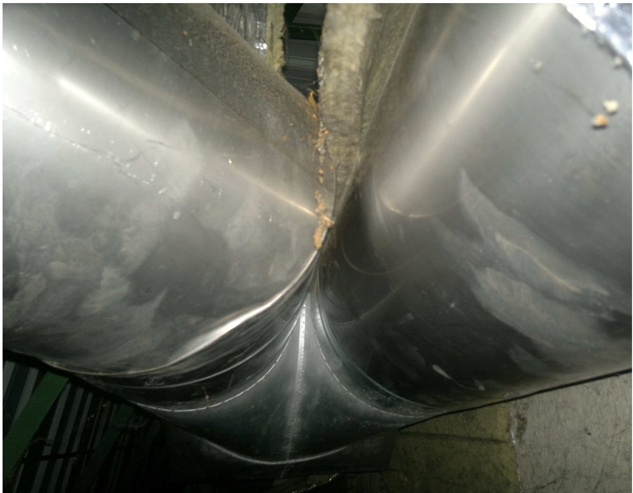
Nieizolowany trójnik kanału wlotowego („portki”) – połączenie z kominem.
