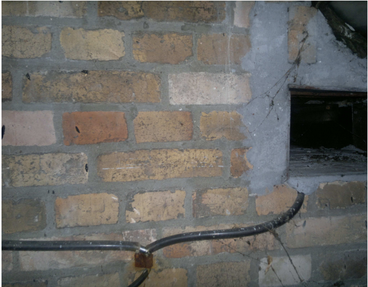
Odpływ kondensatu pionu kominowego – niedrożny wężyk z powodu zbyt małej średnicy – brak możliwości udrożnienia z powodu utrudnionego dostępu do kapsla odpływu kondensatu.
