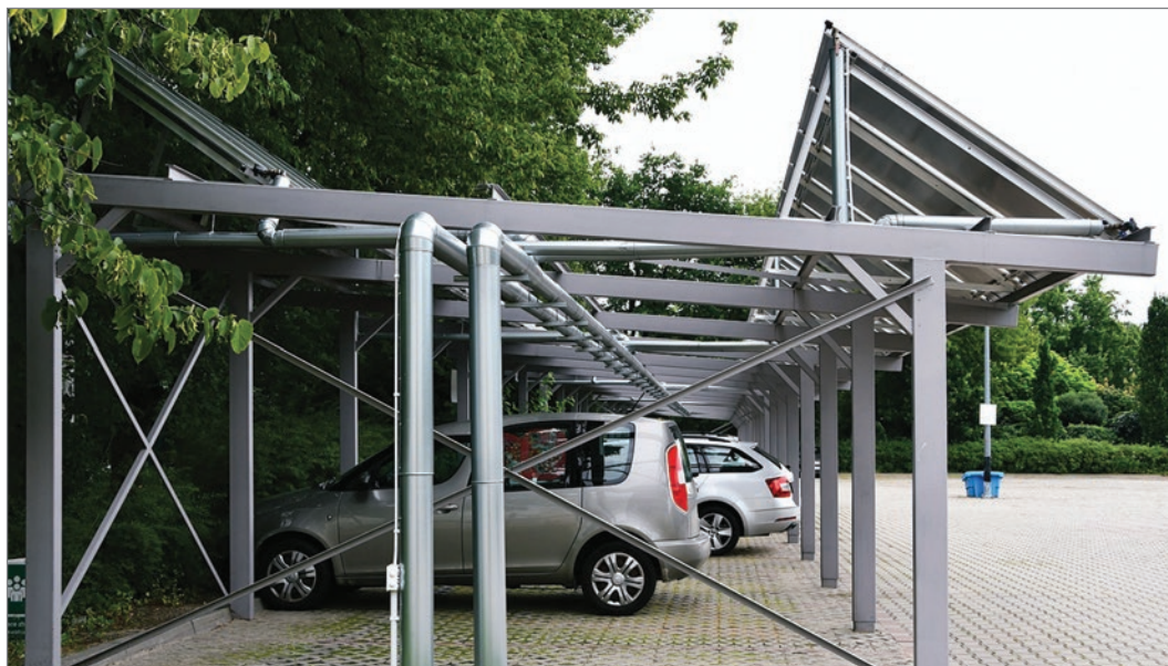
Konstrukcja wsporna. Panele fotowoltaiczne przy budynku GUS
