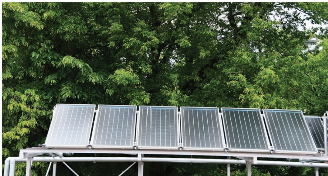
Panele fotowoltaiczne przy budynku GUS
