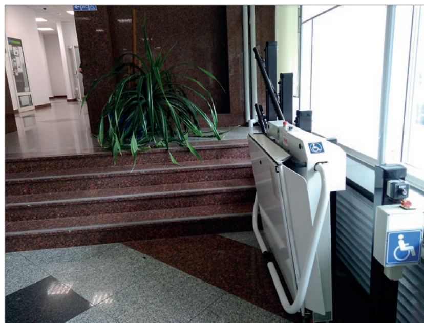
Dostępność architektoniczna w budynku GUS. Platforma dla wózków inwalidzkich
