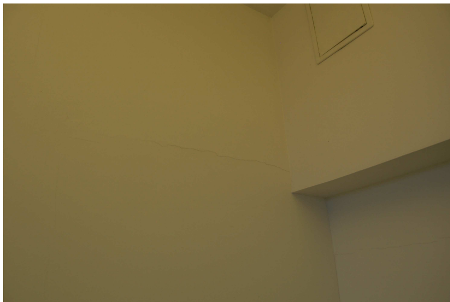
Fotografia nr 14 ; Hol na kondygnacji VII, skrzydło C. Widoczne pęknięcia ściany wewnętrznej.
