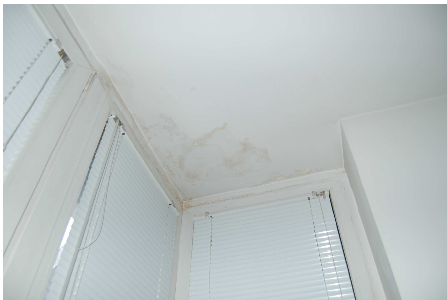
Fotografia nr 9 ; Pomieszczenie biurowe nr 648a, skrzydło A. Widoczne wykwity związane z zawilgoceniem stropu.
