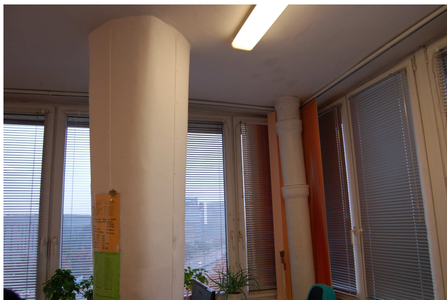
Fotografia nr 7 ; Pomieszczenie biurowe nr 639a, skrzydło A. Widoczne wykwyty związane z zawilgoceniem stropu przy przejściu rury kanalizacji deszczowej.
