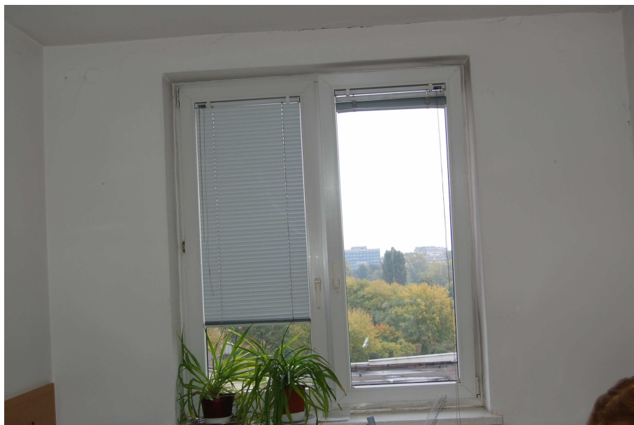
Fotografia nr 3 ; Pomieszczenie biurowe nr 568, skrzydło C. Widoczne poziome pęknięcia pomiędzy ścianą, a stropem na kondygnacji V.
