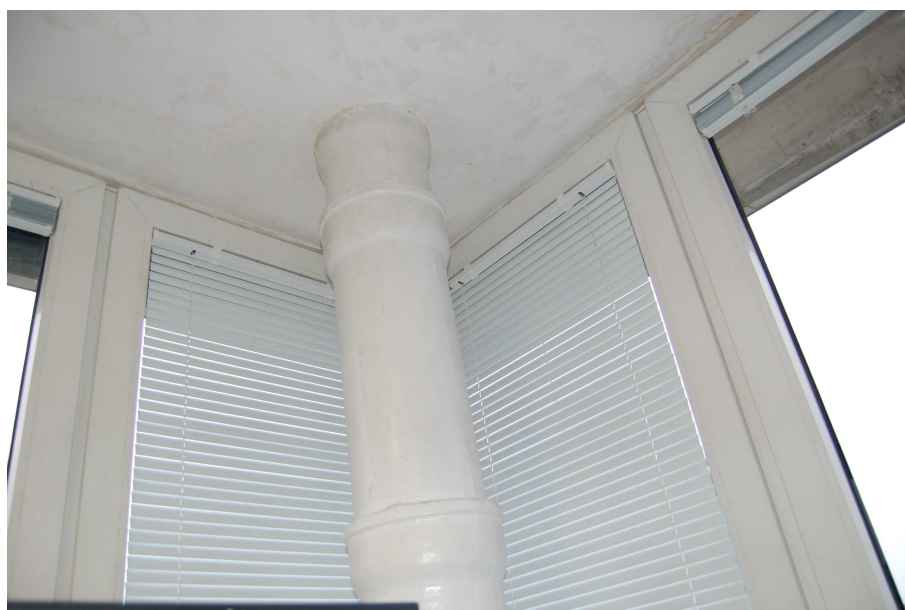
Fotografia nr 6 ; Pomieszczenie biurowe nr 637, skrzydło A. Widoczne wykwyty związane z zawilgoceniem stropu przy przejściu rury kanalizacji deszczowej.
