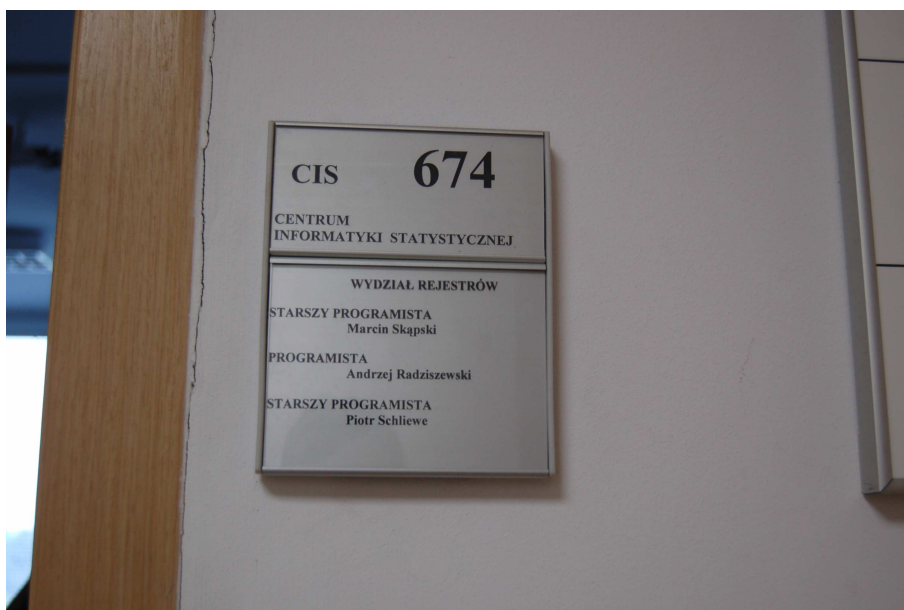
Fotografia nr 10 ; Pomieszczenie biurowe nr 674, skrzydło C. Widoczne pęknięcia na styku ościeżnicy i ściany korytarza.
