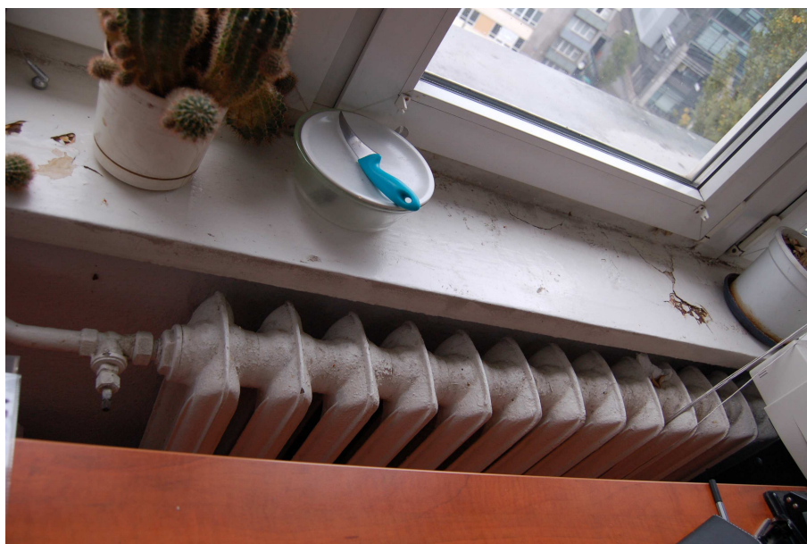
Fotografia nr 4 ; Pomieszczenie biurowe nr 634a, skrzydło A. Widoczny zły stan techniczny parapetu wewnętrznego.
