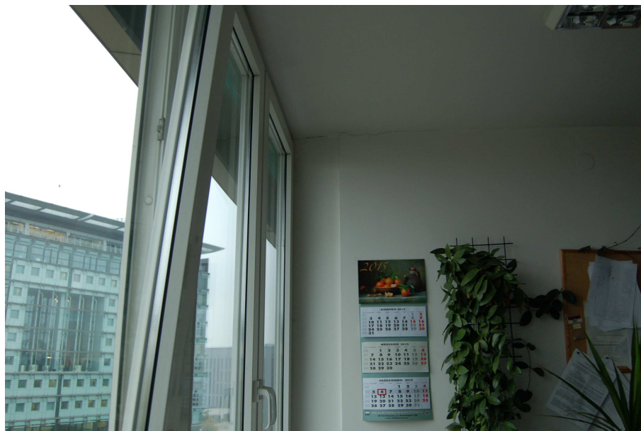
Fotografia nr 5 ; Pomieszczenie biurowe nr 635, skrzydło B. Widoczne pęknięcia w okolicy stuku ściany wewnętrznej z oknem.
