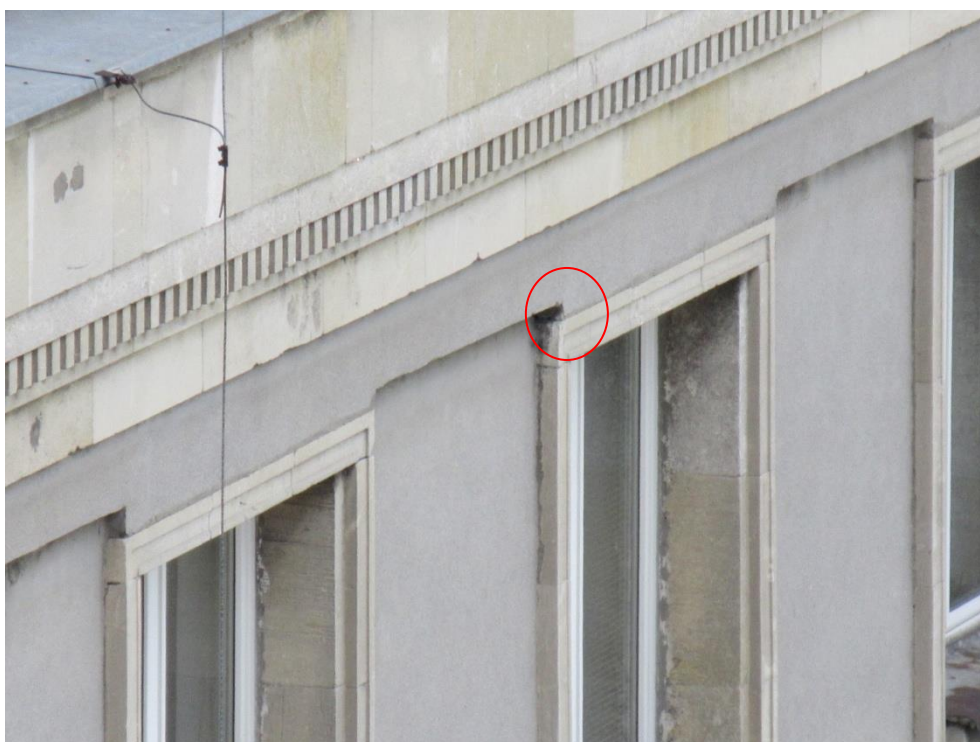
Fot. 26. Gniazdo wróbla nad oknem VI kondygnacji skrzydła południowego, elewacji zachodniej.
