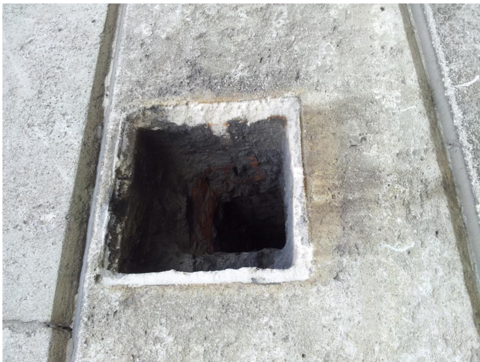
Fot. 13. Niezabezpieczony wlot wentylacyjny w elewacji – skrzydło wschodnie, od strony północnej.
