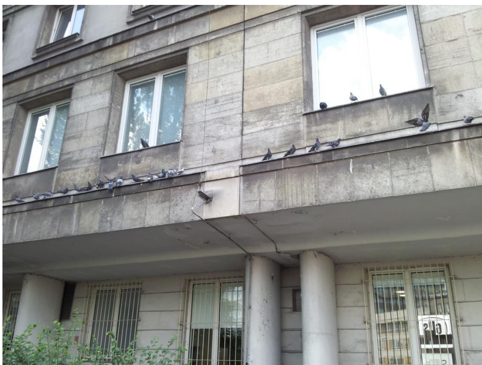
Fot. 24. Najwięcej gołębi obserwuje się na skrzydle zachodnim od strony skrzyżowania al. Niepodległości i al. Armii Ludowej.
