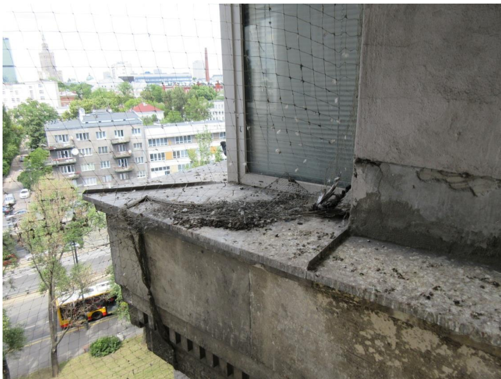
Fot. 21. Zabezpieczenie siatką elewacji na połączeniu skrzydeł budynku i ślady gołębi.
